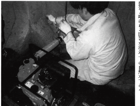
新ポンプエンジン試運転
