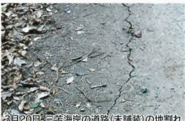
3月20日、三苫海岸の道路(未舗装)の地割れ
