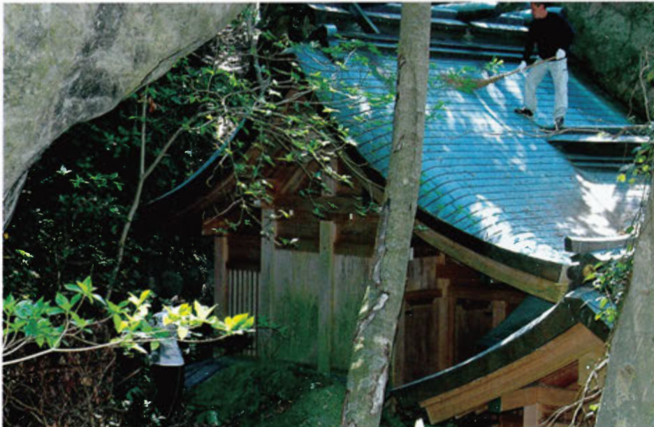
屋根に溜まった落葉もきれいに掃いていただきました
