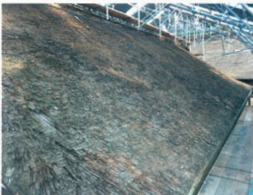
本殿同様、柿葺きの拝殿屋根は平成七年に葺き替えられていますが、葺込銅板が無かった為に板の暴れや腐朽が著しく、鳥害による破損も一部見受けられます。
