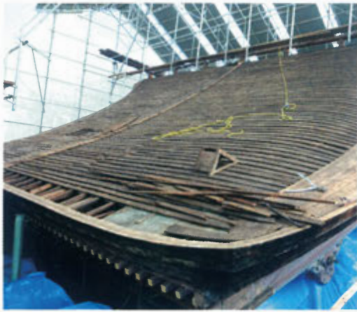
本殿は昭和四十六年に解体修理を行って以来四十二年が経過し、柿葺きの屋根は平葺・軒付とも全体的に磨耗しており、葺込銅板がかなり露出されていました。
