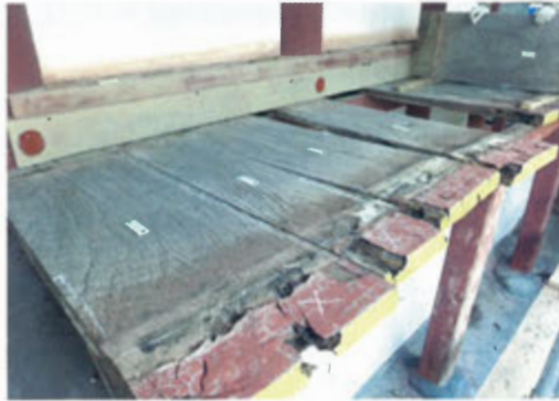
【本殿縁板】高欄を解体したところ、地覆下端部の腐朽が著しかったので、縁板も解体補修となった。
