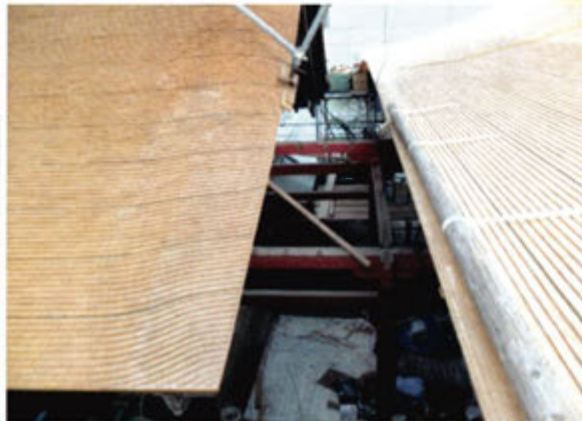
■渡殿修復 屋根が解体されている状況です。参拝者の方々から奉納して頂きました「さわら板」により新たに葺かれます。
